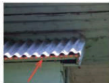
FF-2.4 Neįrengta zakristijų stogelių vandens
