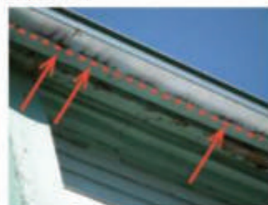
FF-2.2 Korozijos (rūdžių) pažeistas lietovis. Neišvalytose lietoviuose kaupiasi perteklinis vanduo. Lietovis neatlieka savo pagrindinės funkcijos - vanduo pradeda bėgti pro kraštus ir lašėti pro korozijos paveiktas vietas. Atsityje galimos lietovių, stogo konstrukcijos, fasado apdailos padalio (surūdijimas, puvinys).
